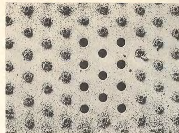
Fig. 2. Perforeret plade i indblæsningsanlæg næsten helt lukket af snavs.
